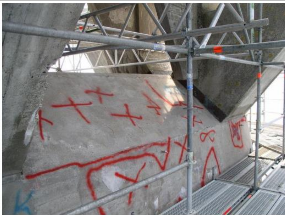
Foto 8:(markering af områder der skal fjernes beton)
