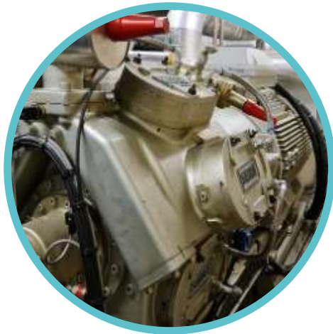
Varmepumpe som primær varmekilde
