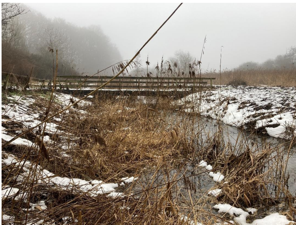
Figur 3-21: Ved passagen af broen i st. 180 ses det tydeligt hvor bredt vandløbet tidligere var gravet. Vegetationen har fået lov at indtage ca. halvdelen af profilet efter mange år med skånsom vedligeholdelse. Foto: NIRAS 2021-03-23
