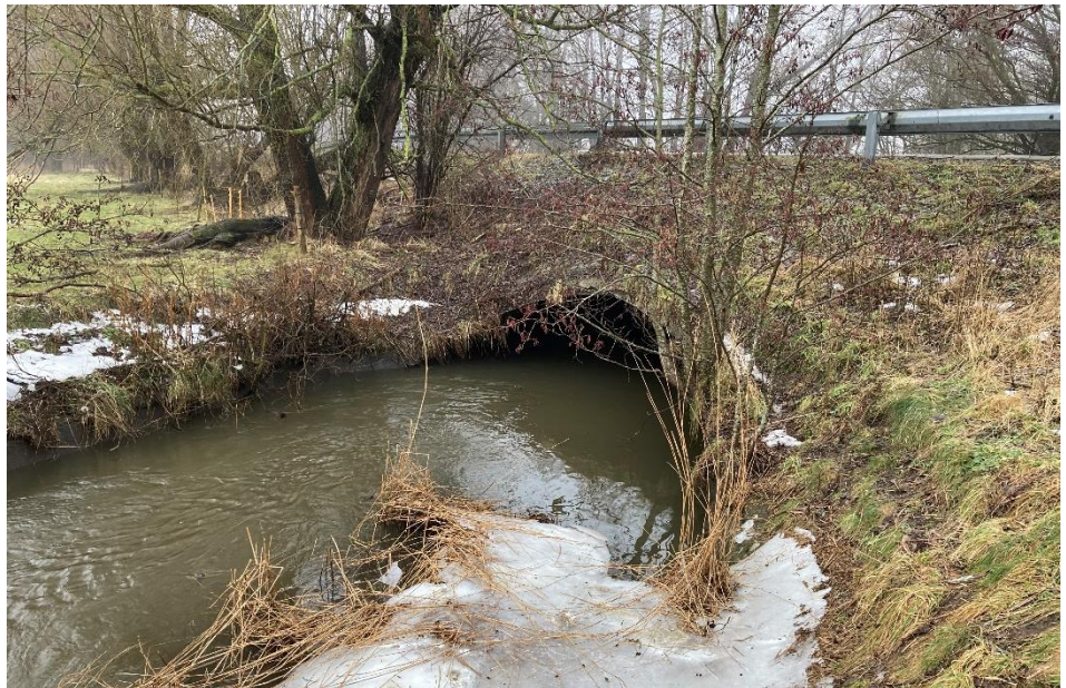
Figur 3-39: Indløbet under Jungshovedvej. Broen er opbygget af et korrugeret stålør. Foto: NIRAS 2021-02-18
