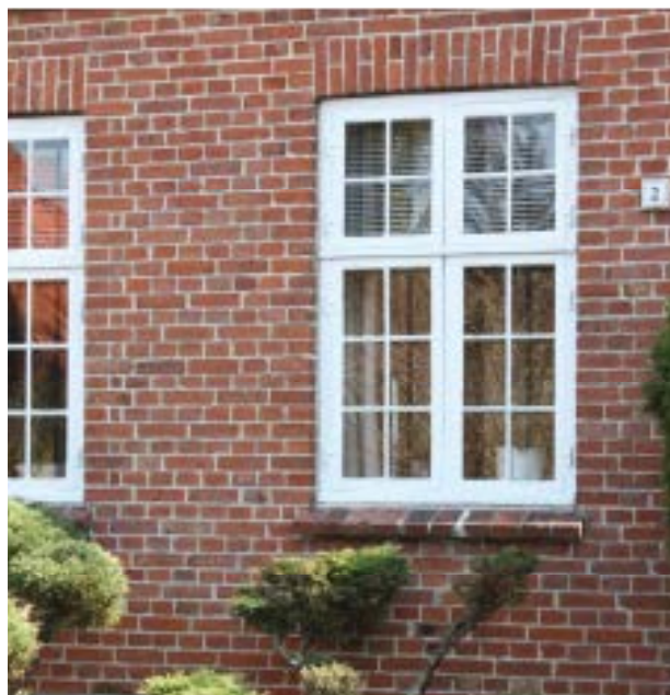
Vinduerne er vigtige for husets bevaringsværdi. Her har vinduerne samme alder og patina som murværket, og de er smukt proportionerede med et nøje afstemt forhold mellem ruder og træværk.
